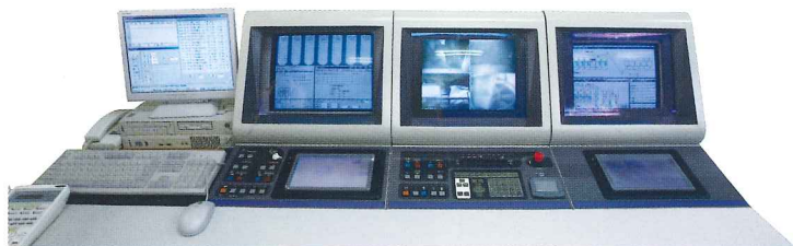
総合管理システム機能を有する操作盤
