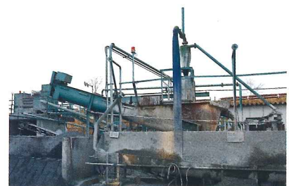
脱水機付全自動排水処理設備
