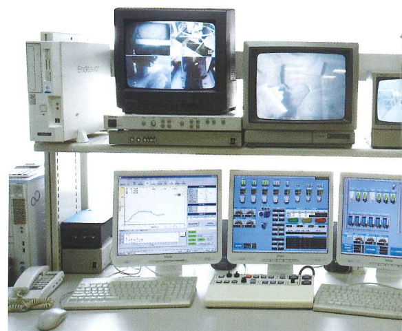
全自動制御方式操作盤
