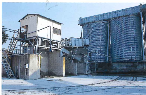
脱水機付全自動排水処理設備
